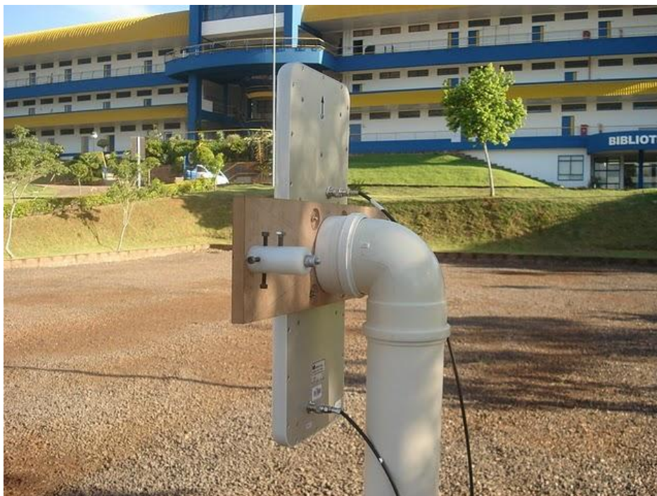
Figura 3 – Suporte com a antena do Leitor RFID instalada e alinhada ao suporte com a Etiqueta RFID (TAG)
