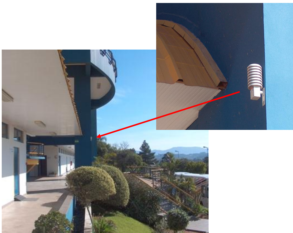
Figura 2 – Local de implantação do sensor para temperatura, umidade e pressão (Prédio D)
